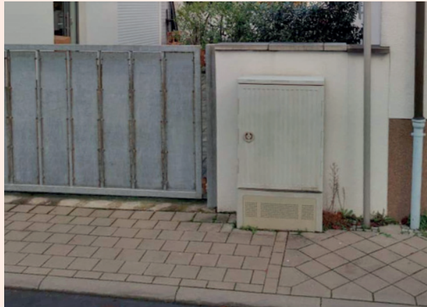
Netzverteiler direkt neben dem Eingangstor
