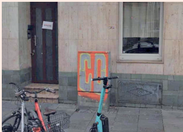
Netzverteiler in unmittelbarer Nähe zum Hauseingang
